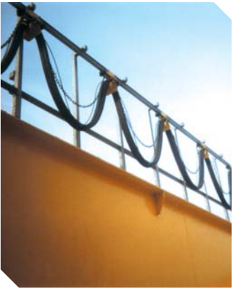
Cables planos en instalación de carros portacables montados en grúa de contenedores RMG.
